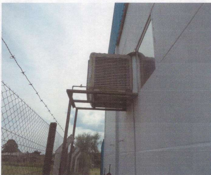
Figura 8: O outro Climatizador instalado no pavilhão da SUL GRAFFME
