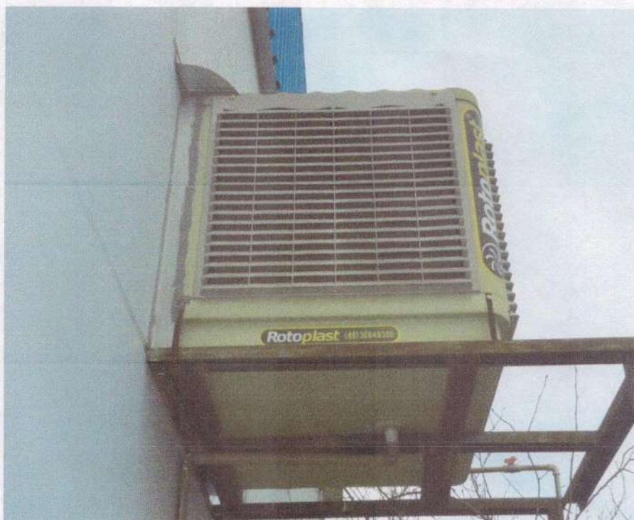
Figura 7: Vista do Climatizador refrigerador evaporativo marca Rotoplast, de Paredem, instalado nos fundos do Pavilhão. São dois aparelhos.
