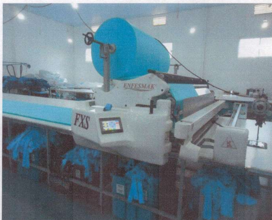
Figura 2: A mesma máquina, vista com seu painel eletrônico, equipamentos diversos e máquina cortadora, instalada e funcionando.
