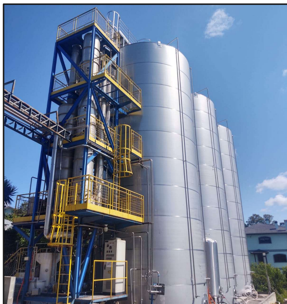
Tanques de armazenamento
