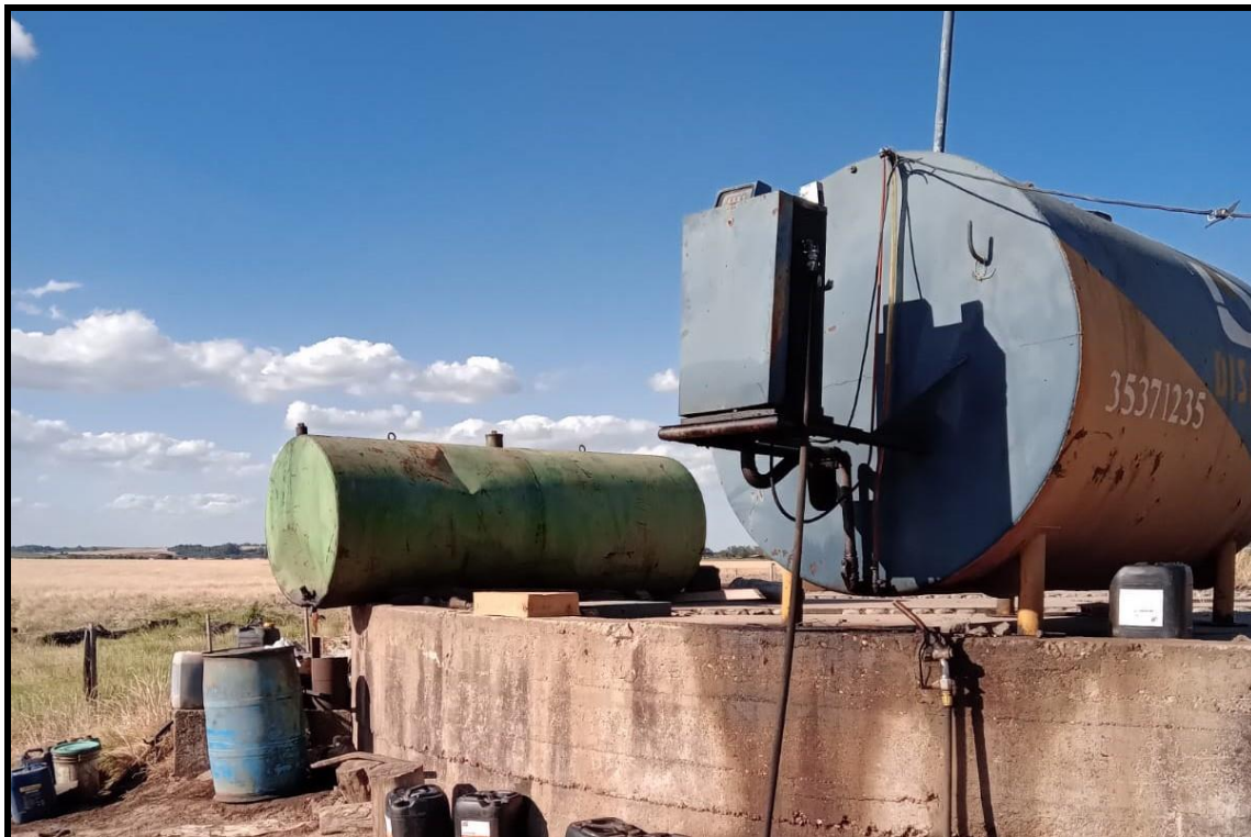
Imagem 17 - Tanque de Combustível 3.000 L e 8.000 L.
