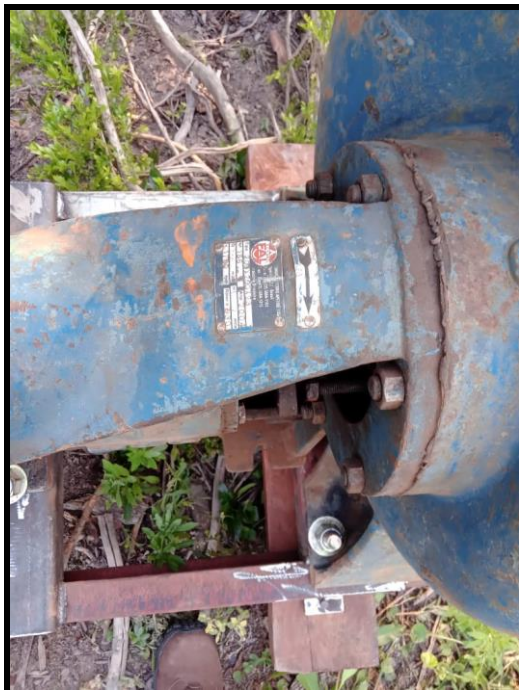
Imagem 22 - Bomba de irrigação, Fal, 200 mm, com motor, ano 2008.
